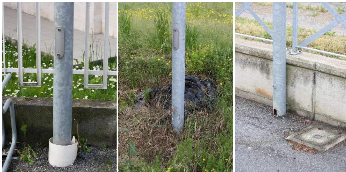
Figura 18 – Stato di conservazione dei pali in acciaio zincato
