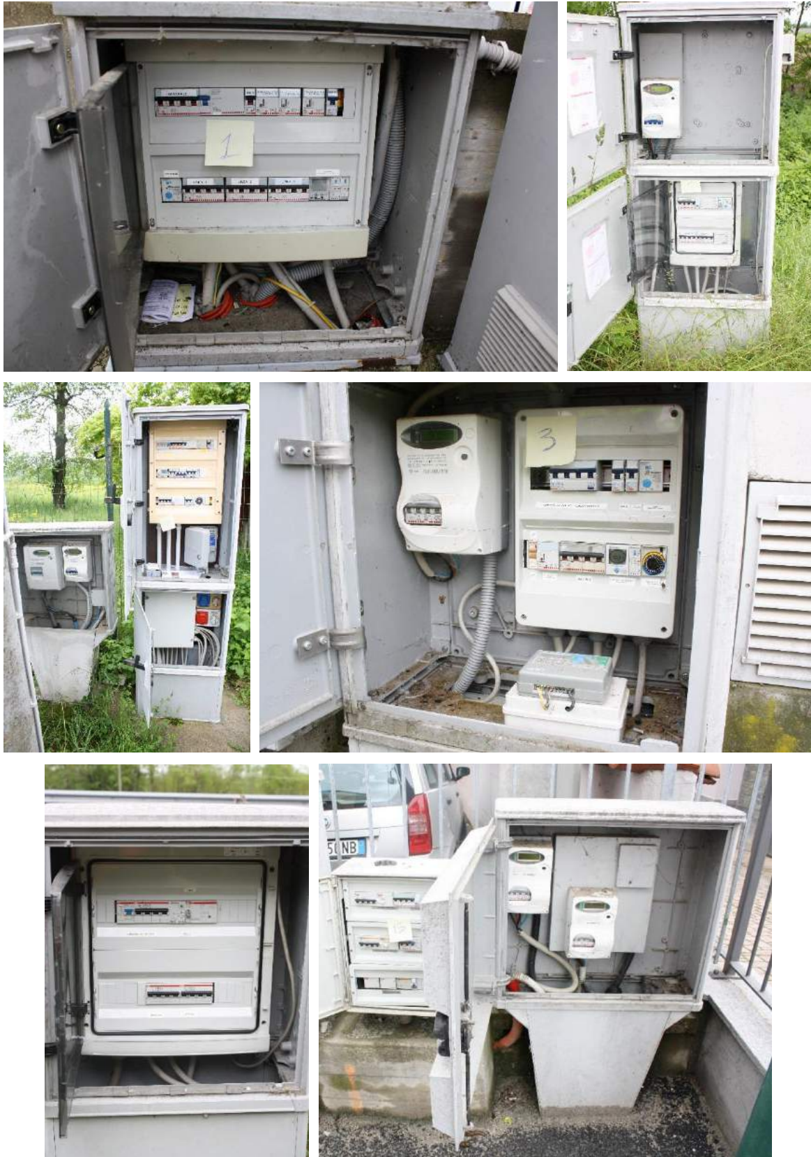
Figura 15 – Vista quadri elettrici e contatori con chiusura di protezione
