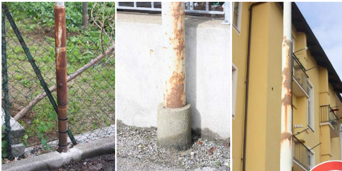
Figura 17 – Criticità rilevate su alcuni sostegni
